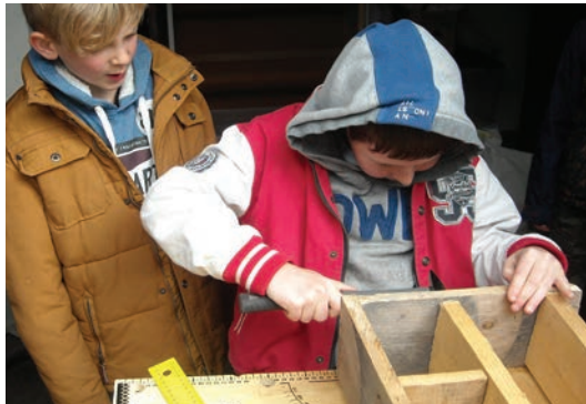
«Hôtel à insectes» : Construction d'un hôtel à insectes pour le sentier didactique.
